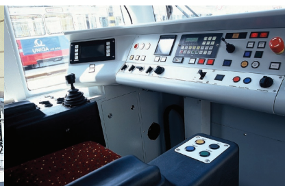
Førerrum i moderne letbanevogn.
